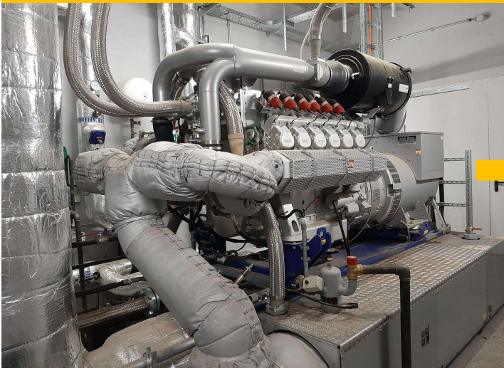
Biogasverbrennung im BHKW
