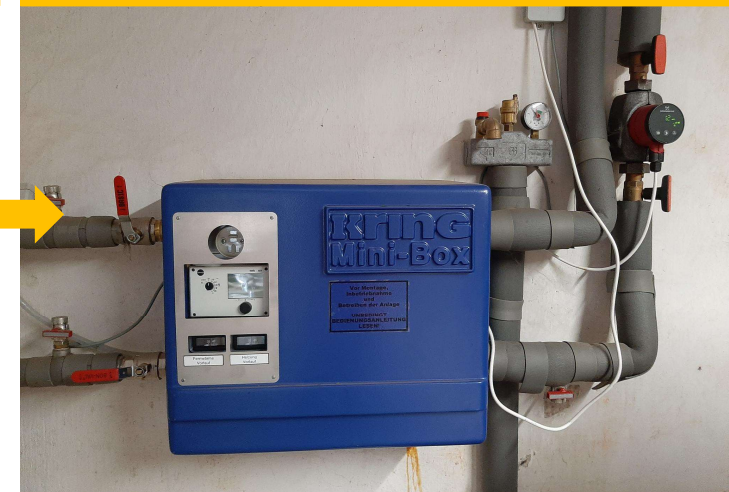
Übergabestation (Wasser-Wasser- Wärmetauscher) in jedem anzuschließenden Haushalt
